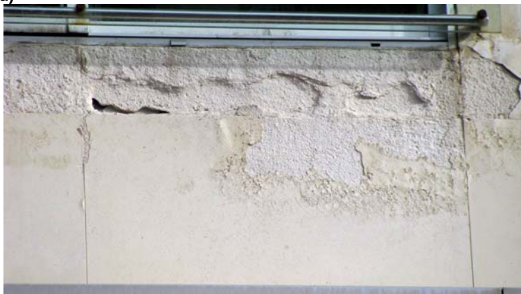
Fig. 1: Exemplos de alterações da pedra em regiões costeiras: a) eflorescência salinas (manchas esbranquiçadas) em pedras vulcânicas; b) erosão por destacamentos da superfície de pedra calcária em construção moderna; c) erosão de pormenores decorativos em pedras graníticas; d) erosão de pedra calcária em construção moderna causando notáveis depressões superficiais.
