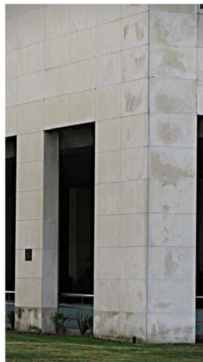
Fig. 5: Ilustração de padrões de alteração típicos: a) ascensão capilar; b) alterações em construção recente de pedras calcárias em vários locais em altura (atribuído a fornecimentos atmosféricos) e com efeitos de ascensão capilar na base.
